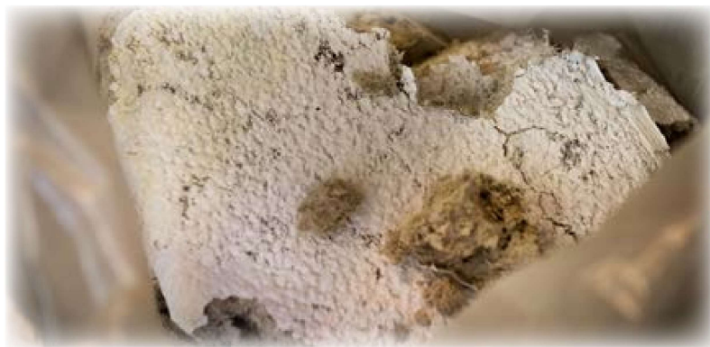
Asbest i isolering. Foto: Hans Alm, Arbetsmiljöverket
