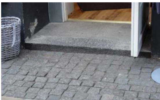
En "onödig" kant, med en liten markförhöjning hade entrén varit mer tillgänglig.
