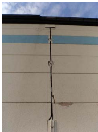
Figur 24. Mellan vissa dilatationsfogar har en cellplastskena innehållande CFC som isolering. Inga mjuka fogar har noterats i dessa springor.
