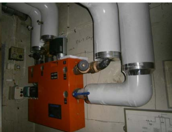
Figur 22. I pannrum finns diverse elutrustning som pumpar, shuntar och styrskåp tillhörande fjärrvärmeanläggningen. Panna och oljetank är utrivna sedan tidigare.
