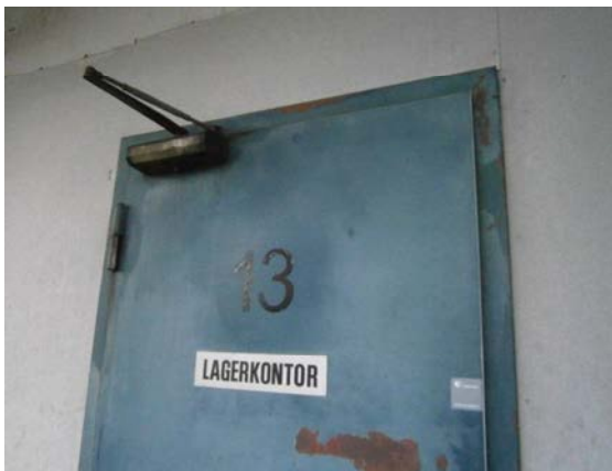
Figur 9. Äldre blå branddörrar innehåller asbest i låskistan.
