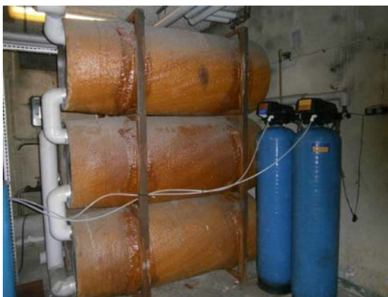
Figur 21. Äldre ackumulatortankar i pannrum-källare del 1 är isolerade med CFC. Sorteras som farligt avfall.
