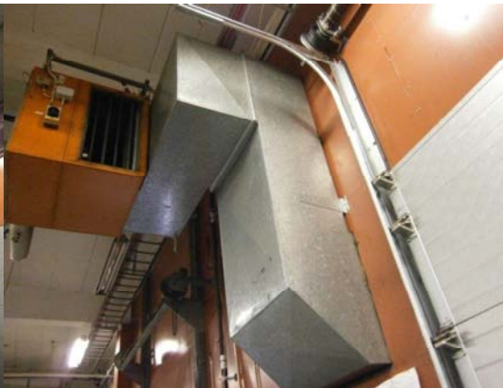
Figur 16. Värmefläktar i hallarna sorteras som el-avfall.
