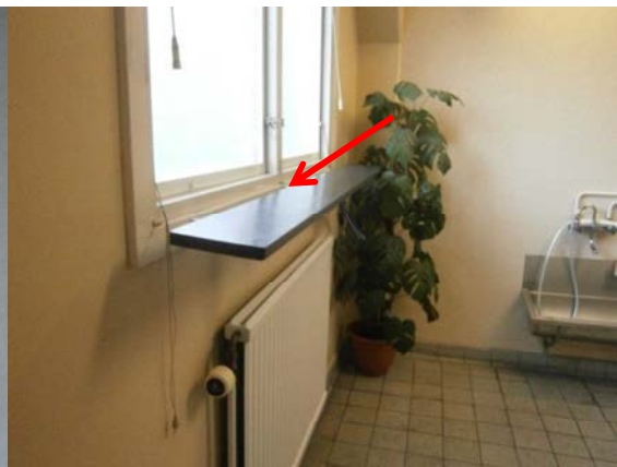
Figur 10. I omklädningsrummet damernas påträffades 3 st. äldre fönsterbrädor av asbestcement.
