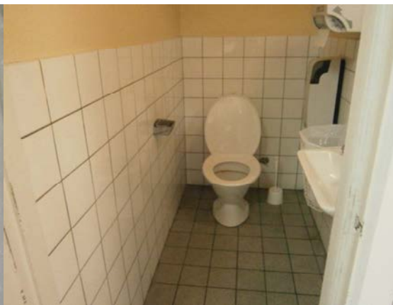
Figur 4. Kakel på WC sitter i fix, fixet innehåller asbest enligt analys, kakel och fix saneras som asbest.
