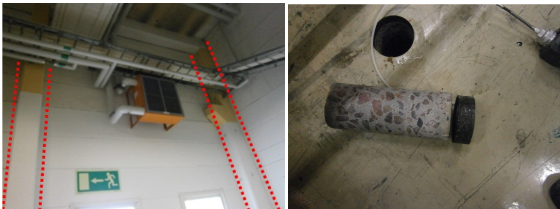
Figur 3 Foto på pelare med asbestinnehållande fogar t v. Th pågjutning av asfaltsbetong.
