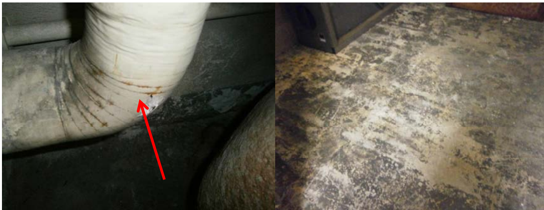
Figur 11. Det finns ett fåtal värmerör i pannrum och skyddsrum som har kvar asbestisolering i rörböjen. De flesta har dock byts ut i samband med att oljepannan byttes ut mot fjärrvärme.
