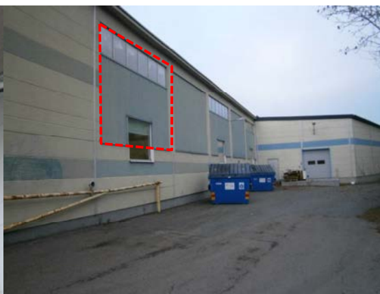
Figur 6. Byggnad från 1964. Bakom alla plåtarna, se ex. röd streckat i figuren finns äldre glaspartier som är fogade runt om med en asbest fog. Finns runt alla dessa partier på södra sida.
