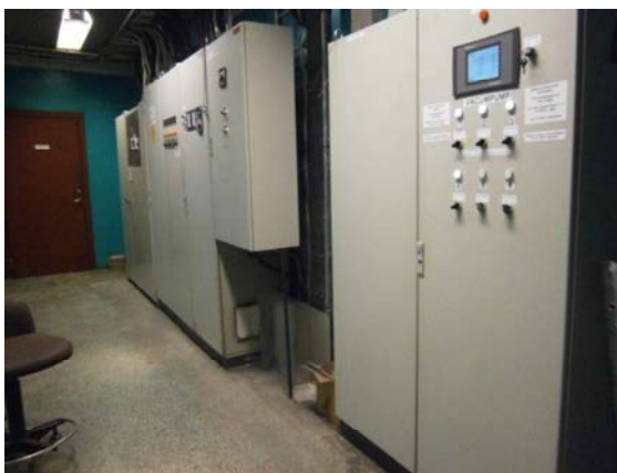
Figur 19. Större styrskåp i del 2, de som tillhör aggregat kommer ingå i denna rivning, de som tillhör kompressor tas med av Bong vid flytt. Sorteras som el-avfall.
