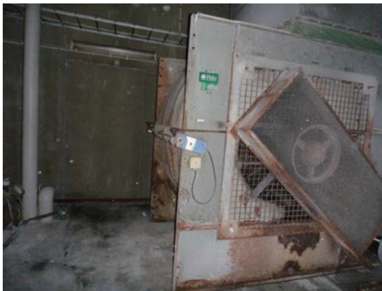
Figur 17. Fläktaggregat är enligt Bong från 1988. Ingen asbest har noterats. Foto från del 2.
