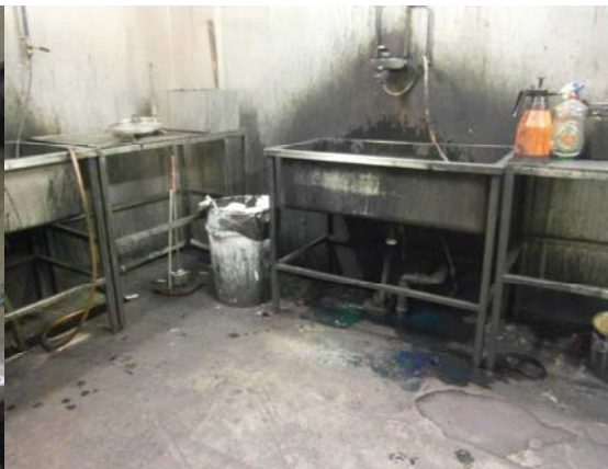
Figur 14. Ytor är ställvis förorenade av färgspill och oljor under maskiner. Dessa skall saneras av innan rivningen startar.
