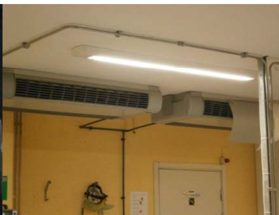
Figur 20. Kylaggregat i del 1, köldmedia töms innan demontering och resterande sorter. Finns även ett antal vitvaror som kyl/frys.
