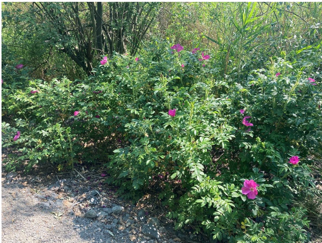
Figur 4. En av de två förekomsterna av vresros inom området. Arten grävs bort med grävskopa och marken kontrolleras noggrant efter rötter.
