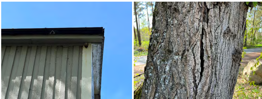
Figur 13. Bilden till vänster visar ett av många hål under taket på folkparksbyggnaden. Här syns även spår av fågelspillning. På bilden till höger syns grov lös bark på en av popplarna utanför folkparksbyggnaden.
