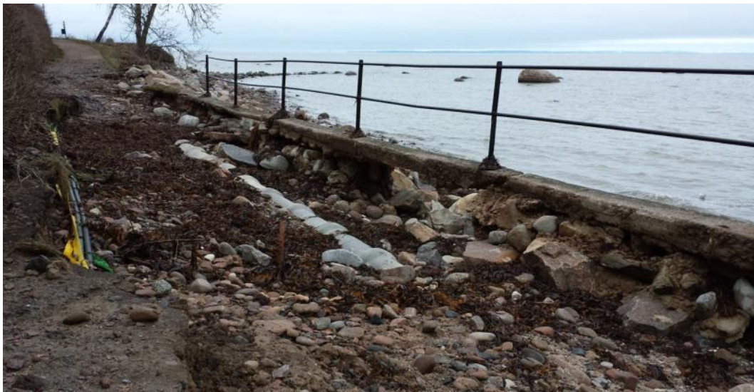
Figur 2-5 Erosionsskador på strandpromenaden längs kusten. I bilden syns hur beläggning spolats bort och VA-ledningar blottlagts.
