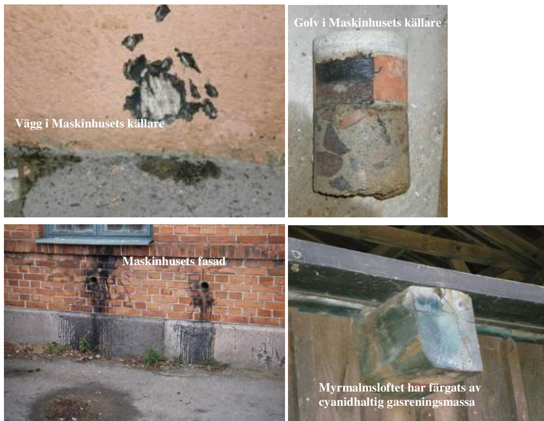
Figur 6 Foton som visar kontaminerade byggnader.
